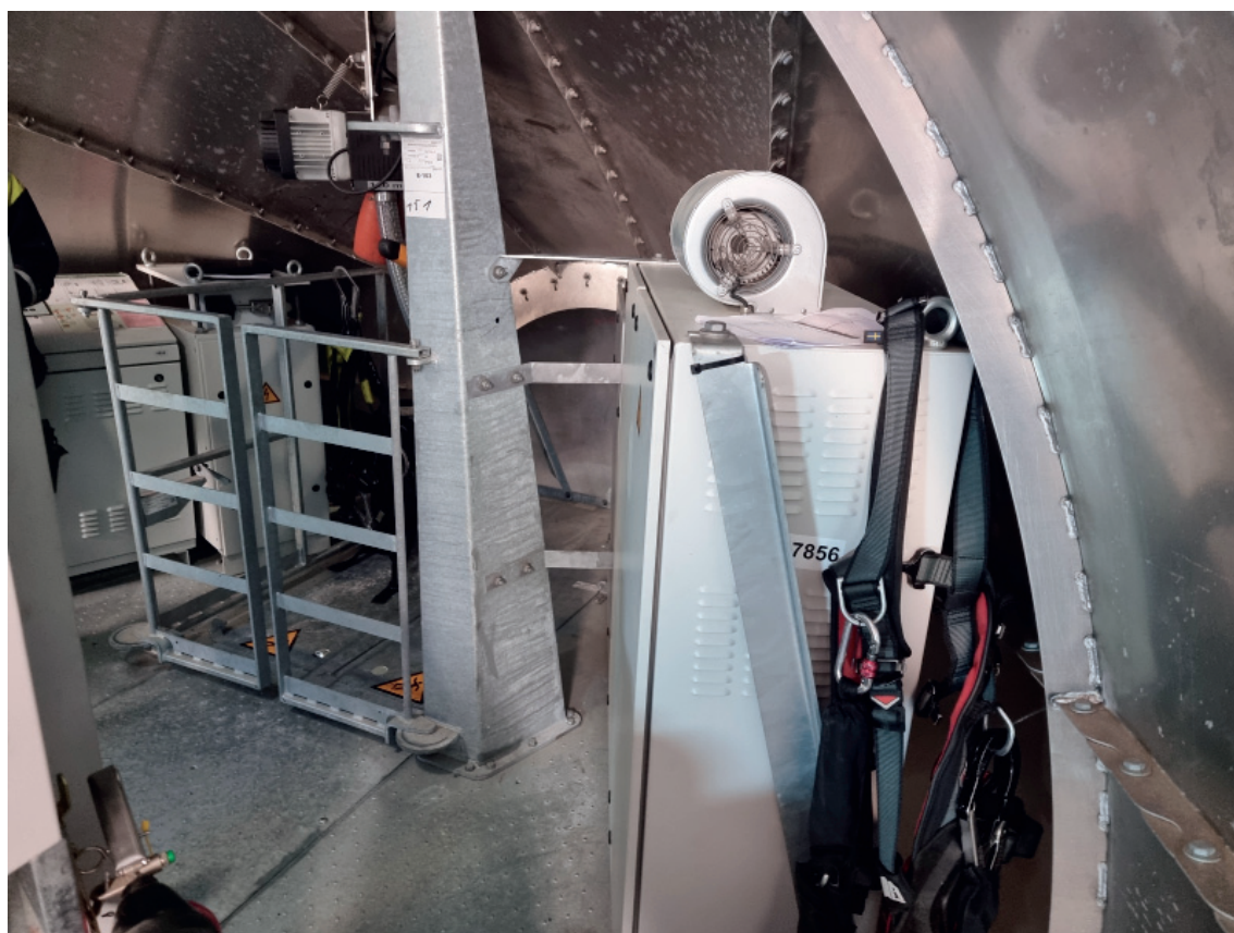
Utrymningshiss i Dalby, fotograferad i samband med 2-årsbesiktning i december 2021
