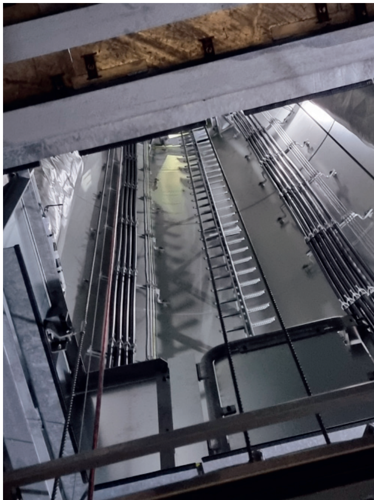
Insidan av tornet i Dalby med klätterstege samt strömkablar
